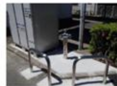
地中にある耐震化された口径の大きな水道管から避難所等まで配水管を整備した応急給水所
