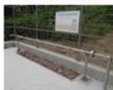
配水池などの水道施設に直接給水栓を整備した応急給水所
