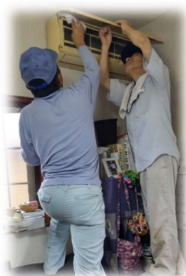
エアコンの清掃
