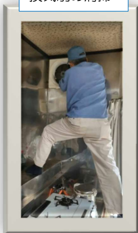
換気扇の清掃
