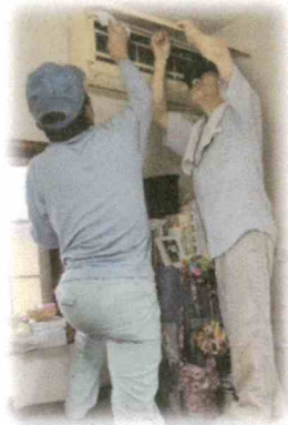
エアコンの清掃
