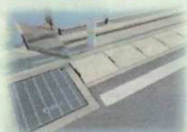
道路側溝・集水桝 [例]側溝蓋のガタツキ
