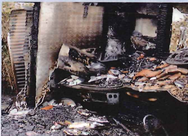
火災後の台所
